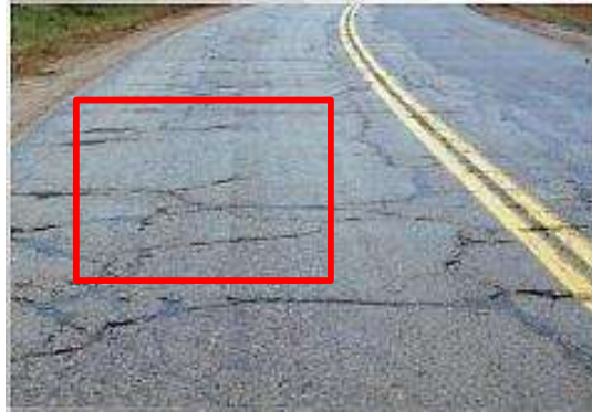
Gambar 2.3 Retak Blok ( Block Cracking ) (Sumber : Hafid, 2013)
