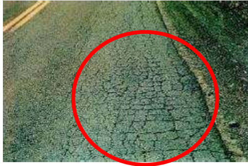
Gambar 2.1 Retak Kulit Buaya ( Alligator Cracking ) (Sumber : Hafid, 2013)
