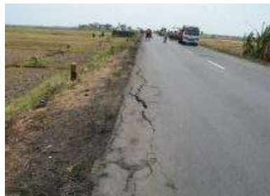
Gambar 2.11 Retak Pinggir ( Edge Crack ) (Sumber : Bahlawant, 2011)
