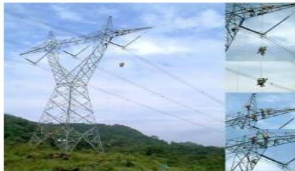
Gambar 2. 8 Saluran Udara Ekstra Tinggi (Tenda & Tumaliang, 2016)
