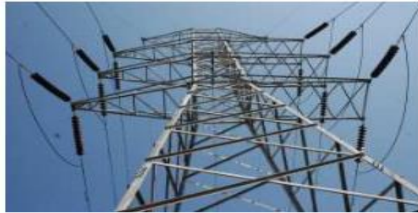
Gambar 2. 9 Saluran Udara Tegangan Tinggi (Tenda & Tumaliang, 2016)
